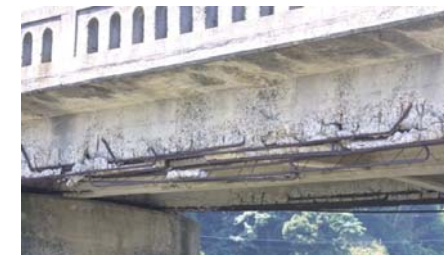
かぶり不足で鉄筋が腐食した橋梁
