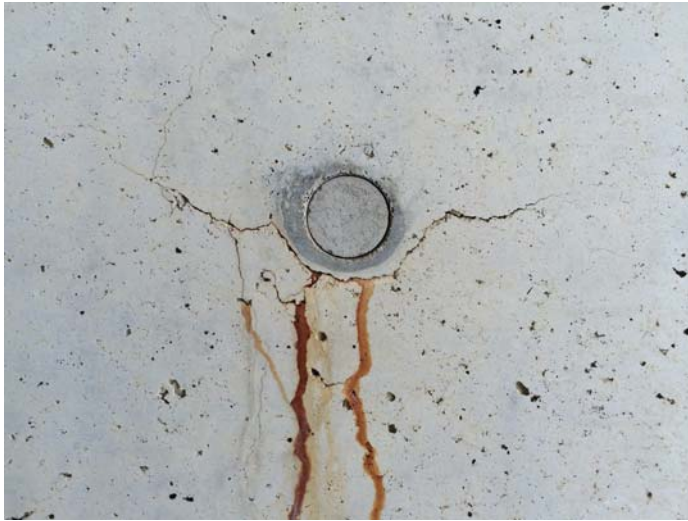
セパレータ下の沈みひび割れから鋼材の錆び汁が出ている。
