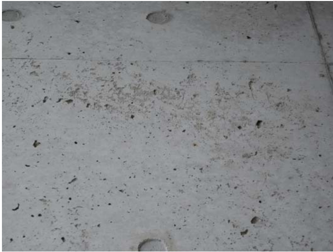
面的な砂すじや多くの気泡。大きな気泡はかぶり不足に繋がる。
