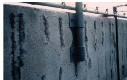
かぶり不足で鉄筋が腐食した高欄
