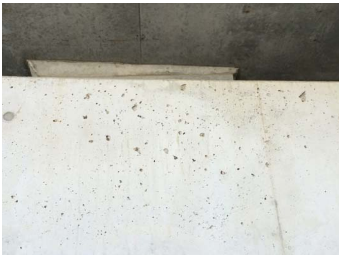
橋台など打重ねていく構造物では、最頂部に気泡が残りやすい。
