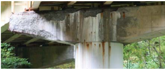
写真 凍結抑制剤によりスケーリング劣化した橋脚 ポイント:水回り(防水)対策を講じておく必要がある。
