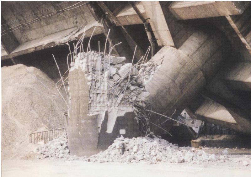
写真 阪神大震災のときにせん断破壊した鉄筋コンクリート柱
