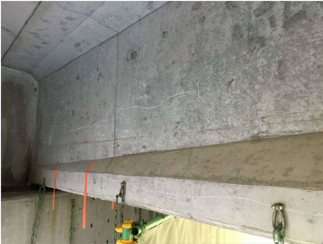
ポステンPCT桁の下フランジ部に発生したひび割れ
