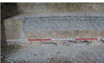
フーチングの鉄筋破断事例
