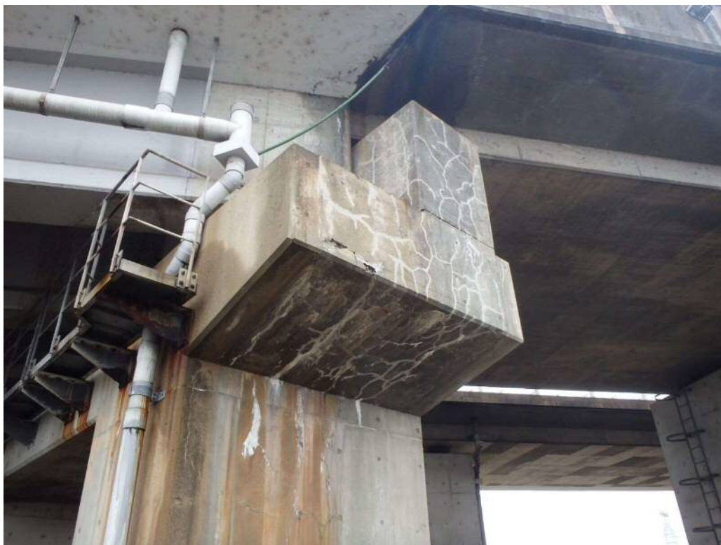
T型橋脚の掛違いのある張出部に発生したひび割れとASRゲルの滲出
