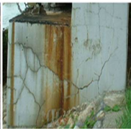
第1次補修(昭和63年)から17年後の状況
