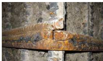
橋脚柱部材の鉄筋破断事例
