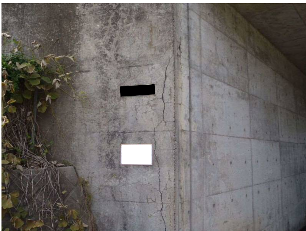
ボックスカルバートの坑口およびウィング付近に発生したひび割れ
