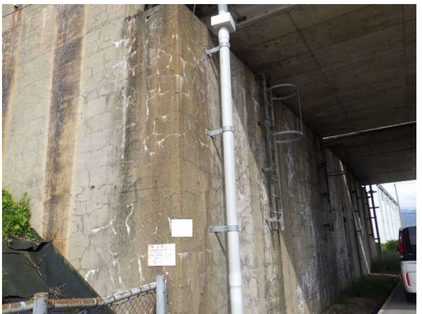
方向性のない亀甲状のひび割れが発生
